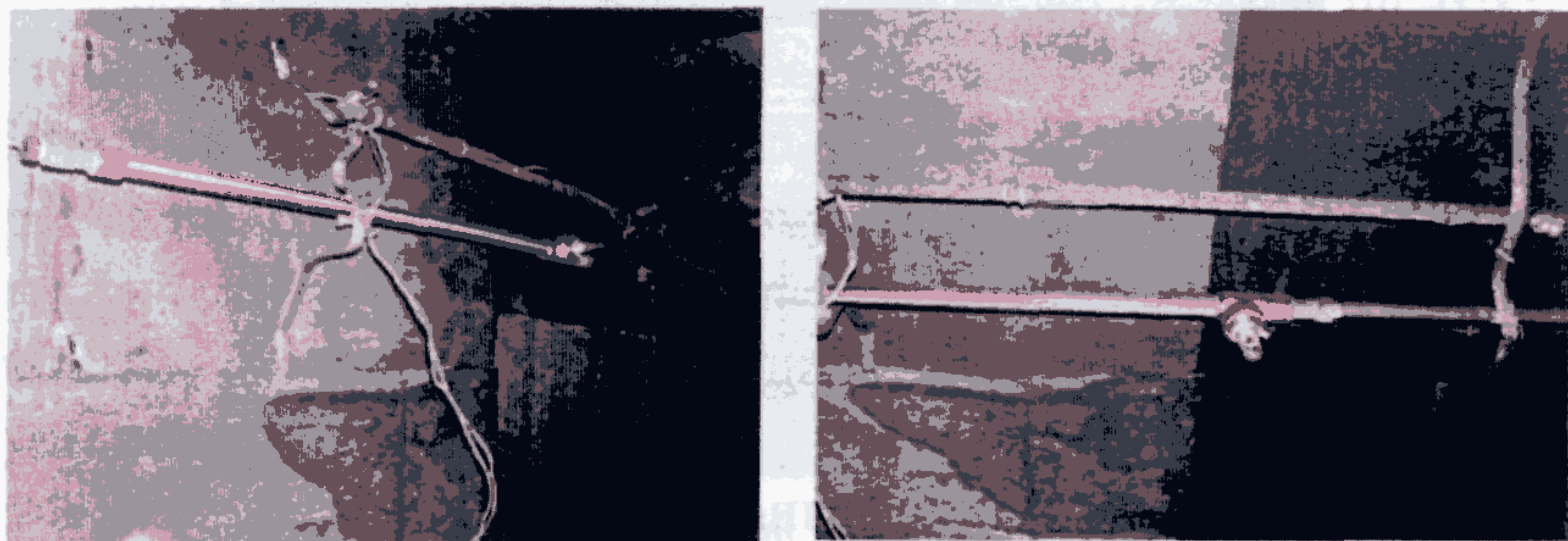
Рисунок Д7 – Состояние трубы D_{\text{наруж}} 32 мм с установленным на ней спринклерным оросителем до и после испытаний (максимальная температура пожара 190–230 °С)
